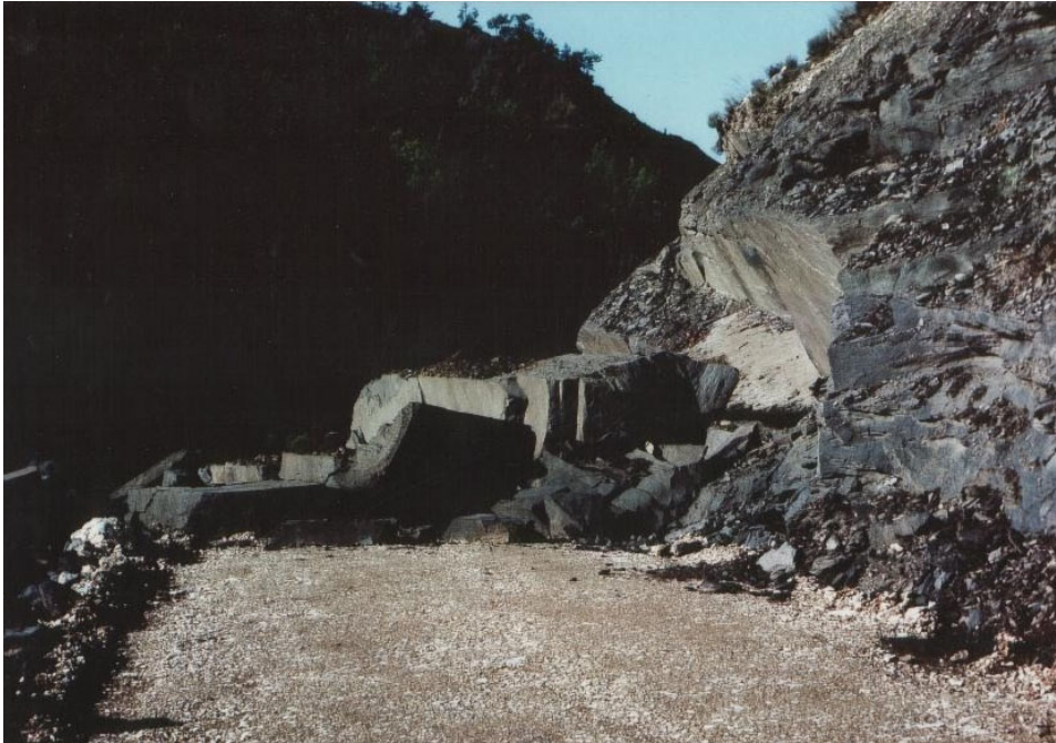
Photo 1. Ecoulement marneux barrant le chemin d'accès au Laval (1987) : il s'est produit quelques jours avant la photo, la marne n'est pas encore altérée.
