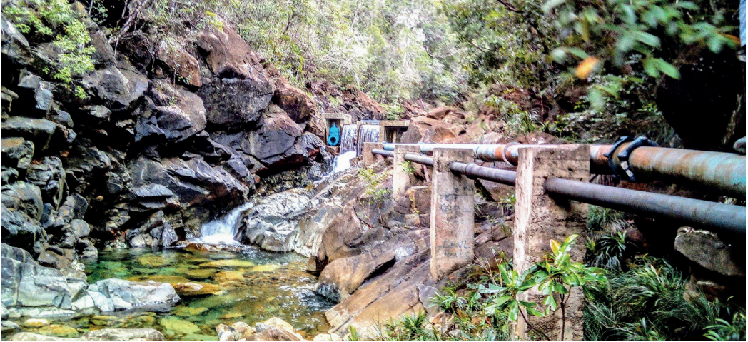
Captage d'eau de distribution – © F. Baumann/Le Banyan Bleu
