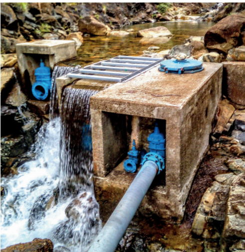
Captage d'eau de distribution – © F. Baumann/Le Banyan Bleu
