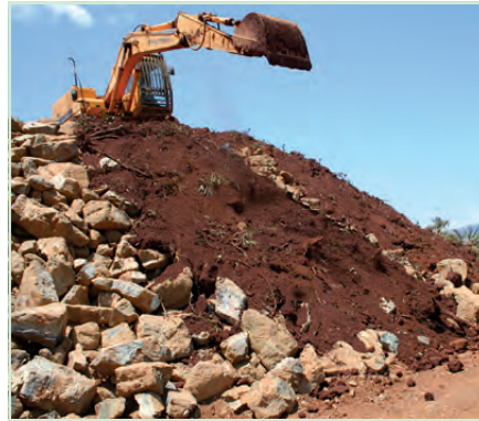
Figure 6.49 : Verse avec topsoil frais épandu sur le talus enroché (mine Vulcain, Tontouta).
