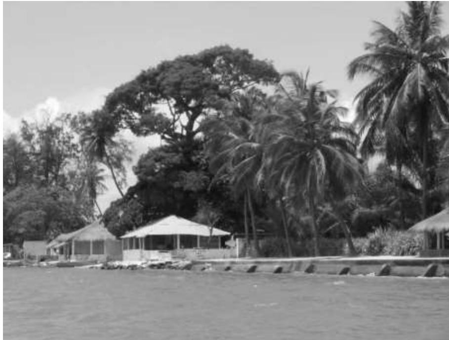
Figure 10. En Casamance ; mur protégeant les maisons contre l'érosion côtière, Carabane, juillet 2014 (embouchure du fleuve Casamance, rive gauche)
