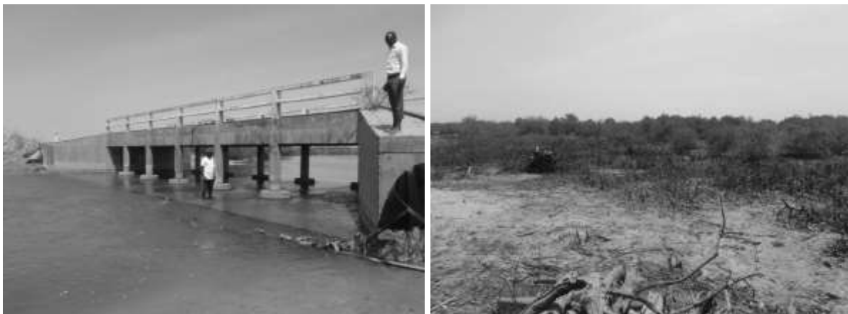
Figure 13 : à gauche un des trois ponts construits sur la piste entre Etama et Bandial (Basse Casamance) ; le bolon a cinq ou six mètres de profondeur ; or la semelle du pont émerge la plupart du temps, laissant passer de très faibles volumes de marée ; à droite : la mangrove morte en « amont » des ponts
