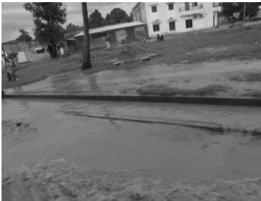
Figure 15. Caniveau fonctionnel (mais en fait en grande partie comblé de sédiments et débris), Ziguinchor, quartier Kandé, août 2014
