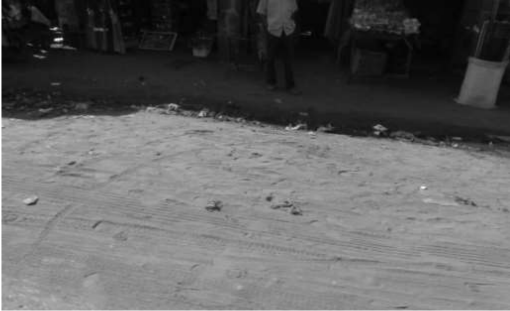
Figure 13. Photo prise fin novembre 2013 montrant un caniveau bouché, comme ils l'étaient pour la plupart d'après les témoignages des riverains
