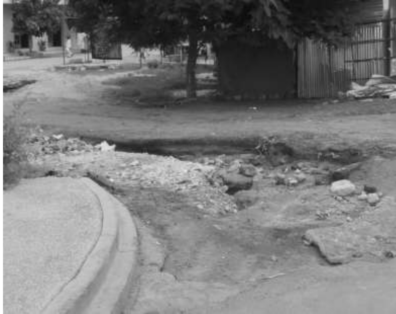
Figure 22 : malgré la relative faiblesse des pentes dans la ville de Dakar, les ravinements ont été nombreux lors de l'épisode pluvieux du 26 août 2012
