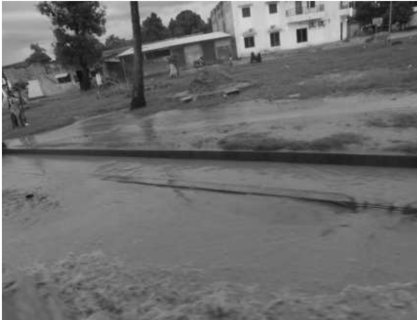
Figure 15. Caniveau fonctionnel (mais en fait en grande partie comblé de sédiments et débris), Ziguinchor, quartier Kandé, août 2014
