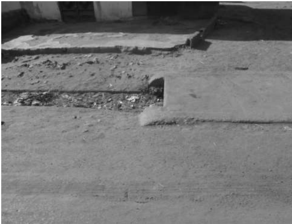
Figure 14. Photo prise fin novembre 2013 montrant un caniveau bouché (Banconi, Bamako)
