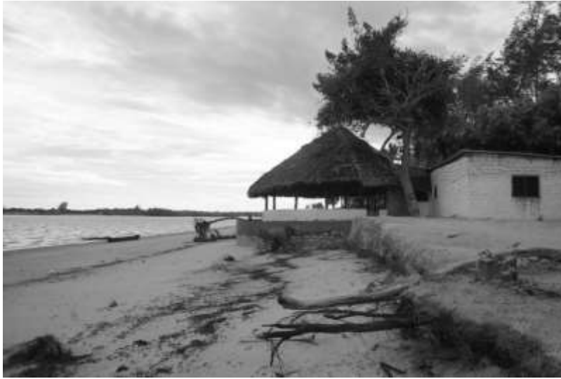
Figure 3 : campement touristique menacé par l'érosion côtière à Kipini (Kenya) (courtoisie de Olivier Hamerlynck et Stéphanie Duvail)
