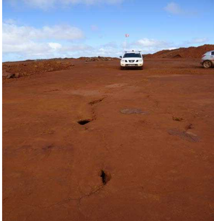
Figure 35 : Instabilités : formation de fissures sur versé (source J. Jeanpert)
